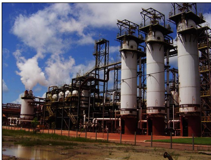
Figura 2.5– Digestores da Hydro Alunorte.
